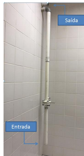
Figura 5. Captação do ar para o trocador (Autoria própria, 2020)
