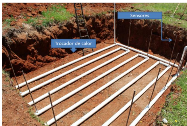
Figura 4. Tubulação do trocador de calor (Autoria própria, 2019)
