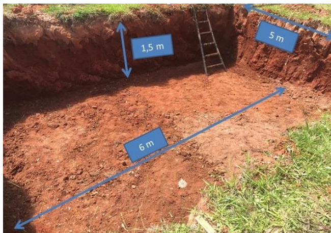
Figura 3. Local para instalação do trocador de calor (Autoria própria, 2019).
