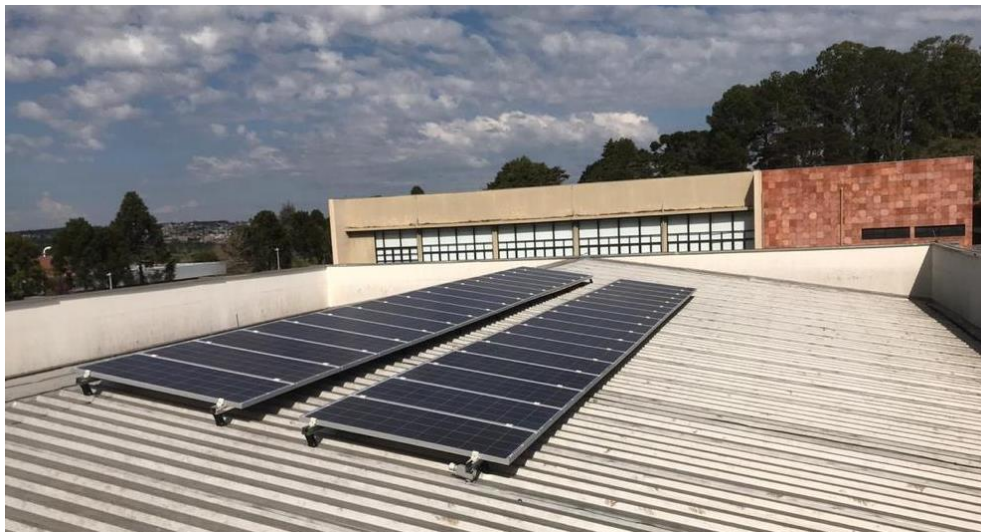
Figura 4. Conjunto de painéis fotovoltaicos do sistema A-CAES
