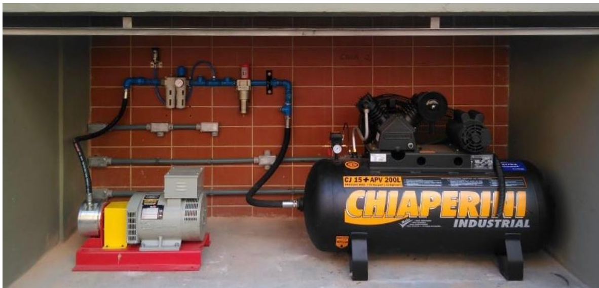
Figura 3. Casa de Compressão e Geração: compressor, reservatório, turbina, alternador elétrico, sistema pneumático de controle, válvula elétrica, válvula, registro, regulador e lubrificador
