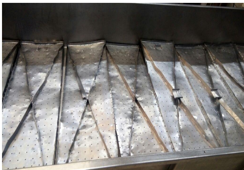
Figura 3. Chapas em uso na Dreno-Prensa com várias avarias em sua estrutura (Autoria própria, 2017)
